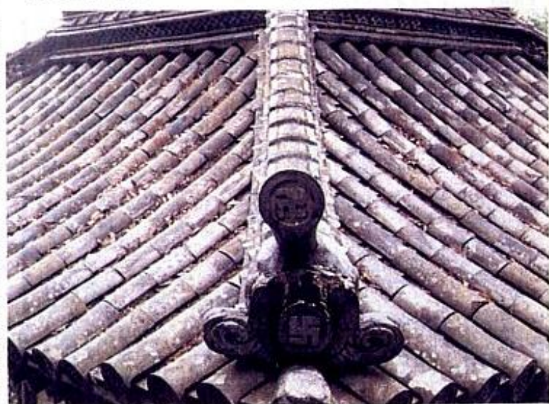
稚児棟をつけない隅降り棟。先端にはシンプルな形の鬼がわらがついている
